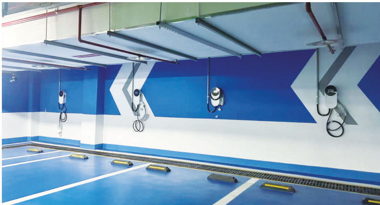
2025年6月7日,重庆医科大学附属第一医院经纬院区,地下车库内多个充电桩均未通电使用。图/陈骅
